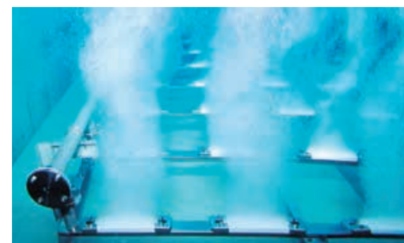
▲ 高度浄水処理 (⑧) (オゾンを注入しているところ)
