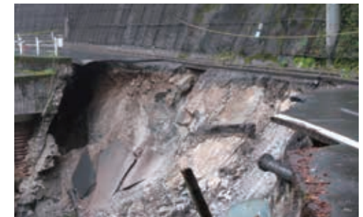
▲ 道路がくずれてこわれてしまった水道管
