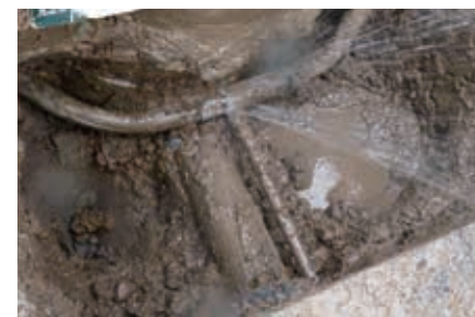
▲ 水道管のろう水 水がふき出しています。
